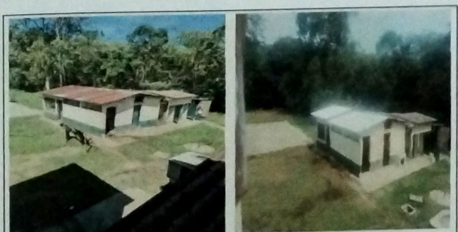
Foto 5: MODULO DE SERVICIOS SANITARIOS Y COCINA Cambio de estructura de metal en mal estado por estructura de metal a base de costaneras. Cambio de lamina de zinc por lamina troquelada cal 26.
