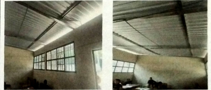
Foto 10: MODULO A AULA. Sustitucion de cubierta de asbesto en mal estado y se coloco estructura de metal a base de costaneras de metal.
