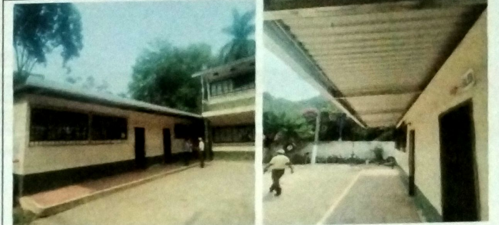
Foto 14: MODULO B AULA Sustitucion de cubierta de asbesto en mal estado y se coloco estructura de metal a base de costaneras de metal. Se instalaron balcones en ventaneria para seguridad.
