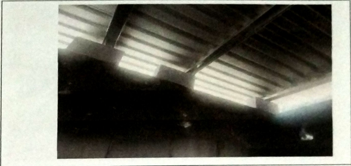
Foto 8: MODULO COCINA Cambio de estructura de metal en mal estado por estructura de metal a base de costaneras. Cambio de lamina de zinc por lamina troquelada cal 26.
